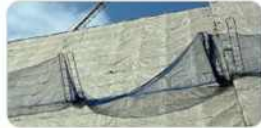
낙하물 방지망 파손
